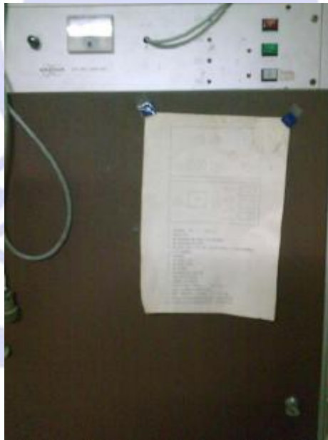
圖 3-13 供給電磁鐵之 Power Supply
