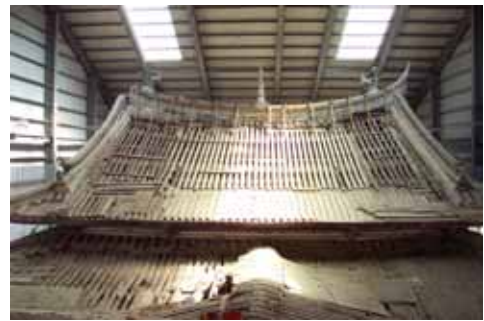
照片 2-20 正殿前屋坡桷仔與暗厝間桷仔搭接分佈位置。(照片來源：寶元)
