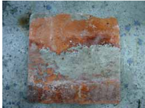
照片 3-45 尺磚表面留有三條接近白色的施工痕跡，可知已被重複使用過三次。(照片來源：寶元)
