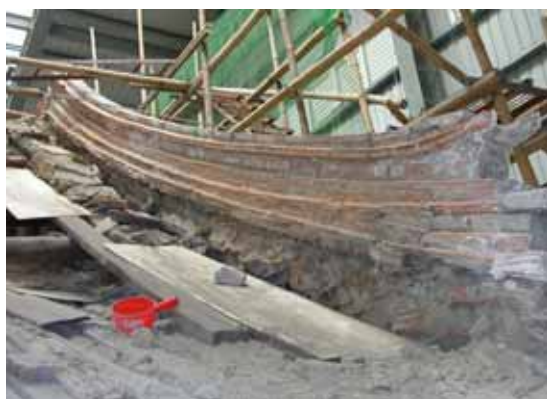
照片 3-1 右後歸帶粉刷層拆除後情形，歸帶下方約三十公分處為舊歸帶遺留支痕跡。（照片來源：寶元）
