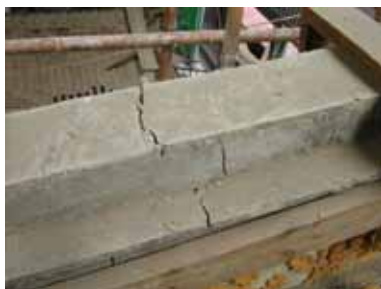
照片 1-4 正殿中脊震後產生多處裂痕。(照片來源：寶元)
