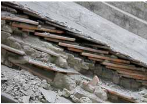
照片 3-26 正殿左前歸帶與屋面交接處，在民國五十年以「疊五露五」的作法修補。 (照片來源：寶元)
