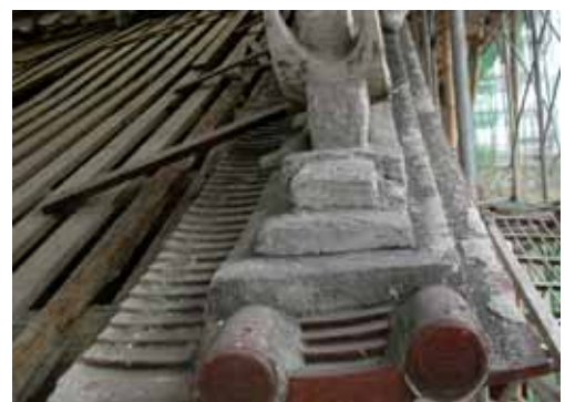
照片 3-25 昭和十一年后殿右側歸帶與屋面交接處，無施作「蜈蚣腳」之情形。(照片來源：寶元)
