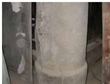
照片 1-5 正殿水泥柱底爆裂。(照片來源：寶元)
