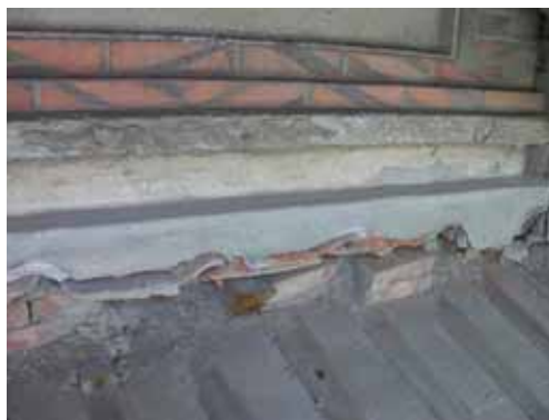
照片 3-14 正殿後側下博脊以混凝土、紅磚、碎瓦填補。(照片來源：賈元)
