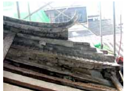
照片 3-6 后殿檐口約 20 公分厚之土灰。(照片來源：寶元)
