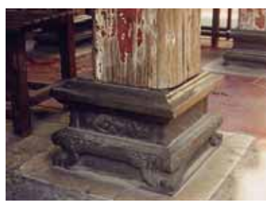
照片 1-6 戲臺木柱位移。(照片來源：寶元)
