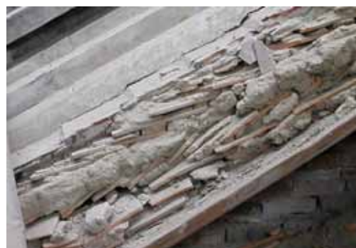
照片 3-19 正殿右前屋坡瓦構成方式，第一層為民國七十五年修補之笑瓦，第二層則為道光十一年鋪設之笑瓦。(照片來源：寶元)
