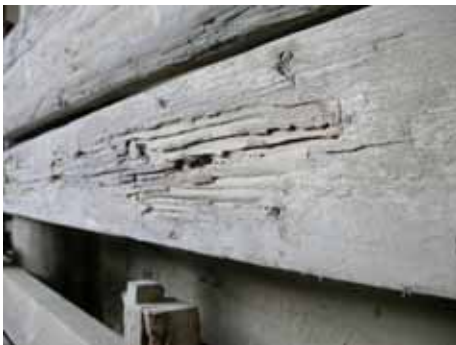
照片 2-37 桷才表面施工痕跡較為平整，斷面亦呈矩形，但由於構築年代較久，而表面產生腐朽情形。(照片來源：寶元)
