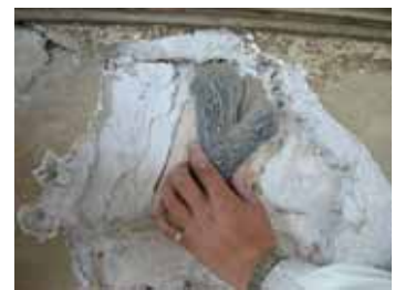
照片 3-78 後側重檐間牆文字堵貼上預留位置後在以細灰泥分刷修飾。(照片來源：寶元)
