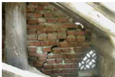
照片 1-2 正殿左側內山牆多道裂痕。(照片來源：寶元)
