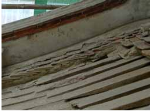
照片 3-2 拜亭全屋面土灰厚度皆為五公分左右。(照片來源：寶元)
