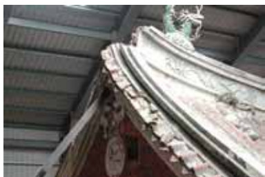
照片 1-1 正殿右側翹脊斷裂掉落。(照片來源：寶元)
