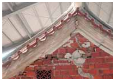
照片 1-3 正殿左側外山牆磚體鬆脫掉落。(照片來源：寶元)
