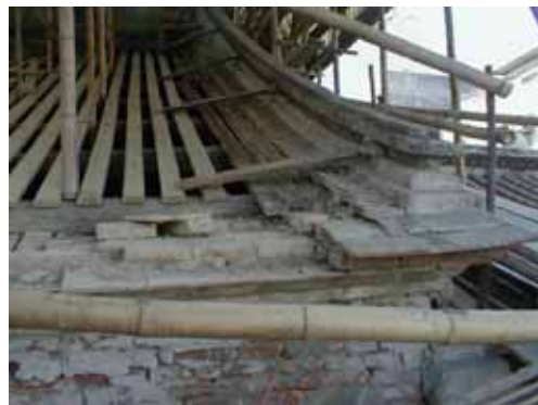
照片 2-28 后殿屋坡與山牆交接面桷仔因長時間來修繕而嚴重腐壞情形。(照片來源：寶元)
