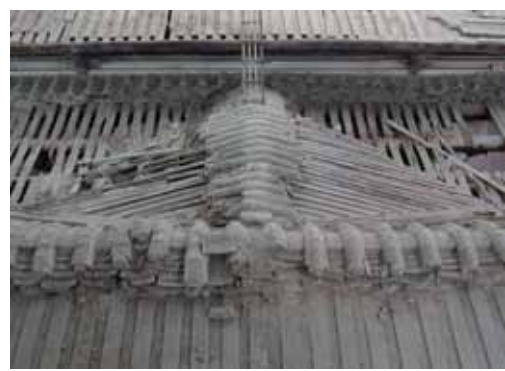
照片 2-26 龜背桷仔配置及損壞情形。(照片來源：寶元)
