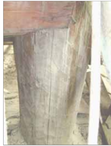
照片 2-15 支撐暗厝楹仔之童柱上留有早期施作手斧痕跡。(照片來源：賈元)
