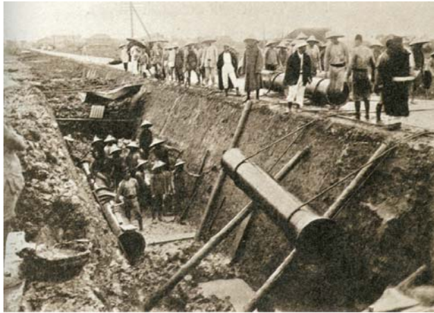
圖【2-10】自來水管鋪設工程 資料來源：經典雜誌 2006《台灣醫療四百年》
