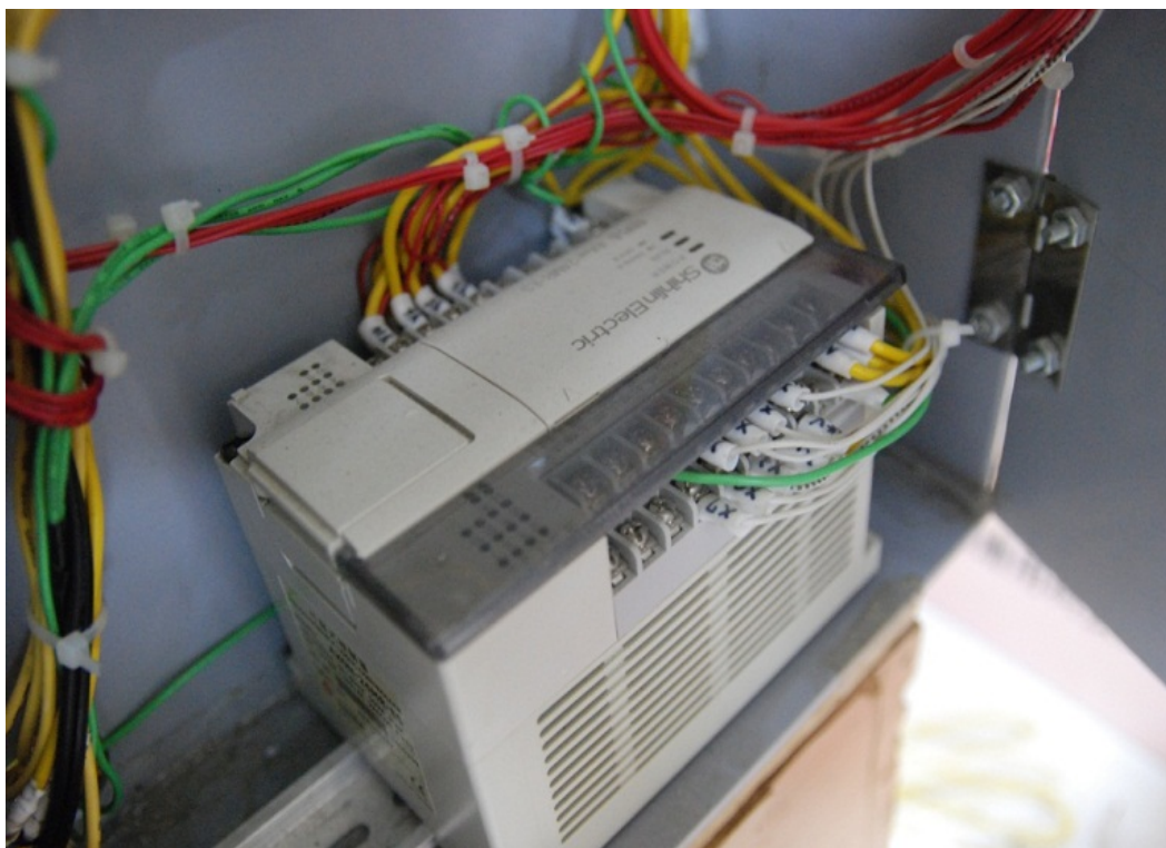
圖 3-2 士林電機 SHIHLIN ELECTRIC PLC 程控設備
