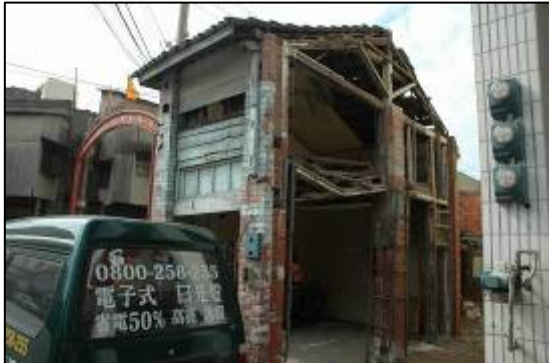
照片 2-2-15 梧棲路民權路路口民宅，磚木混合構造 圖片來源：筆者，2007.03
