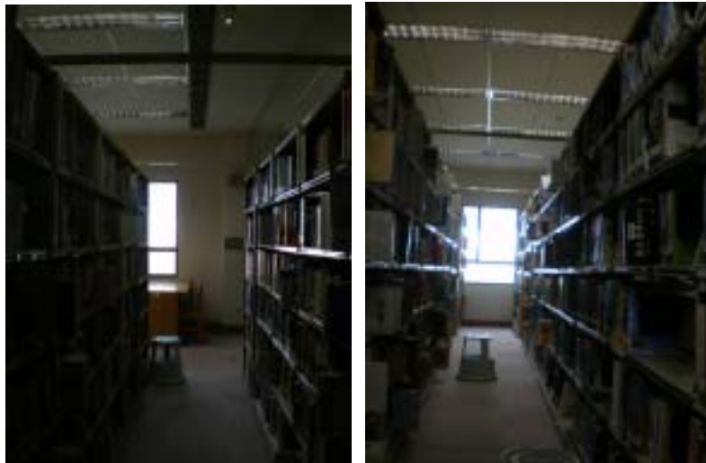
A 燈具使用現況(1)
