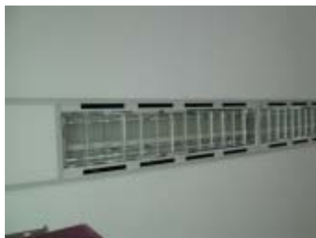
圖 3-20 燈具使用現況
