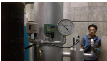
圖 3.6 鍋爐使用壓力
