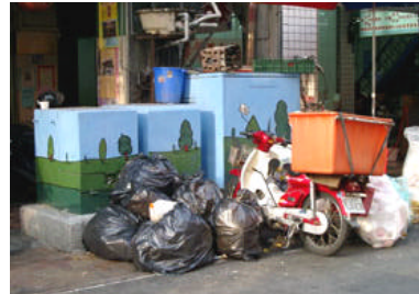
圖 4-14 設施類之變電箱
